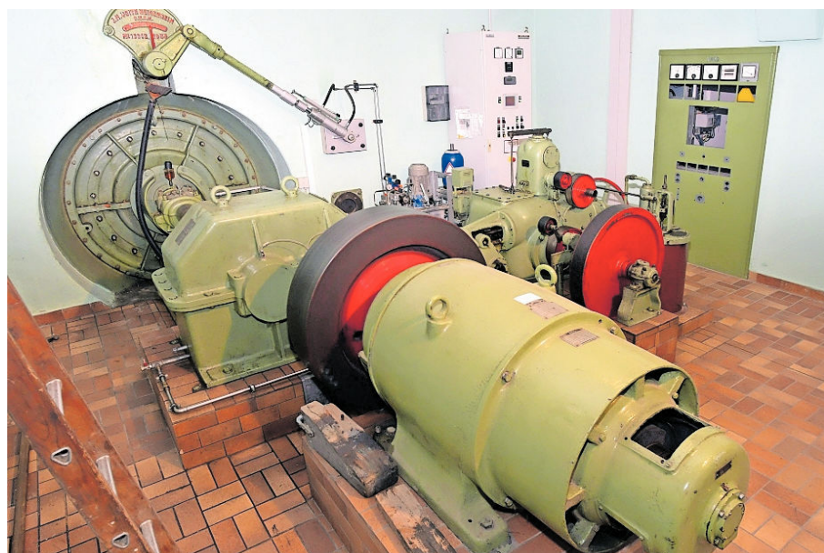
Das Wasserkraftwerk Schwaigerloh mit Generator und Schwungrad. Die moderne Technik versteckt sich in dem schmalen Schrank im Hintergrund. FOTO: RENATE SCHMIDT
